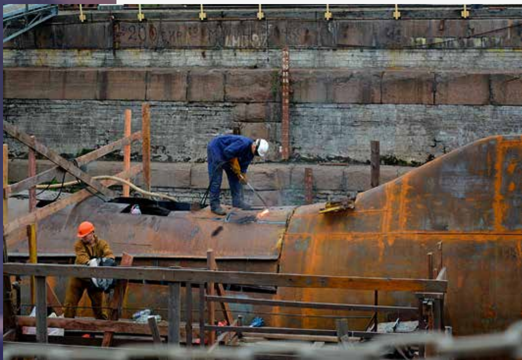
В процессе ремонта АПЛ К-3 «Ленинский Комсомол» / Фото: пресс-служба Кронштадтского морского завода
